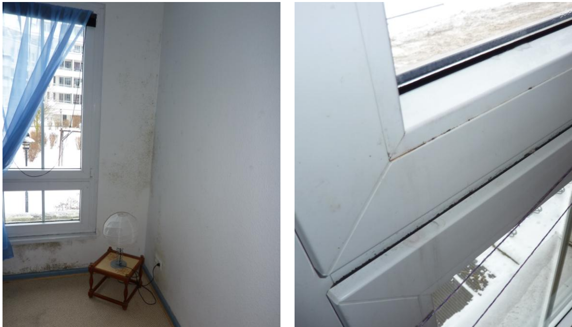
Abb. 12: a) Schadensbild mit Schimmelpilzbildung im Außenwandbereich (links) ; b) Ablaufspuren und Schimmelpilzbildung an Fensterrahmen (rechts)
