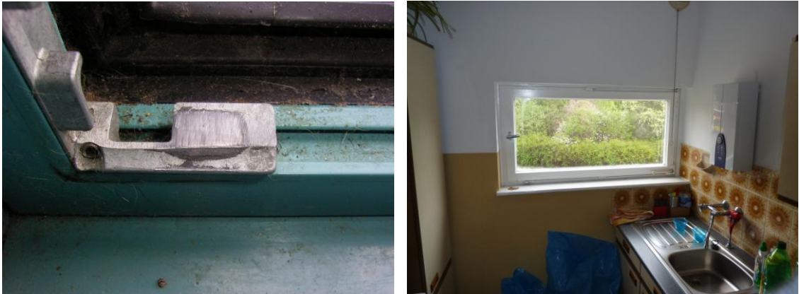
Abb. 23: a) Spanender Abrieb an der Oberseite eines Ecklagers infolge unzureichender Gangbarkeit bzw. unterlassener Instandhaltung des betreffenden Fensterflügels (links); b) „liegendes“ Flügelformat mit Einschränkungen in der Nutzbarkeit einer Küche bei vollständig geöffnetem Fenster (rechts)
