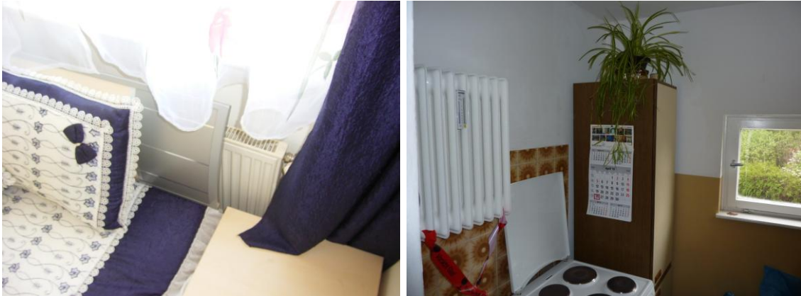
Abb. 24: a) Vollständig abgeschirmter, offensichtlich unwirksamer bzw. nicht betriebener Heizkörper (links); b) Ungünstige Position eines Heizkörpers an der Innenwand in einer Küche (rechts)
