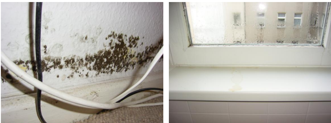
Abb. 1: Schimmelpilzbildung an einer Außenwand (a); links), Tauwasserausfall an der Wärmeschutzverglasung eines Fensters (b); rechts)
